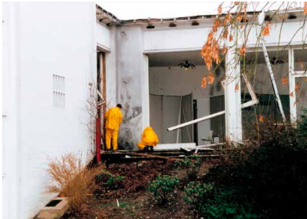
Polizeibeamte bei der kriminaltechnischen Untersuchung des zerstörten Seitenflügels des VHS-Gebäudes (© Stiftung Demokratie Saarland).
