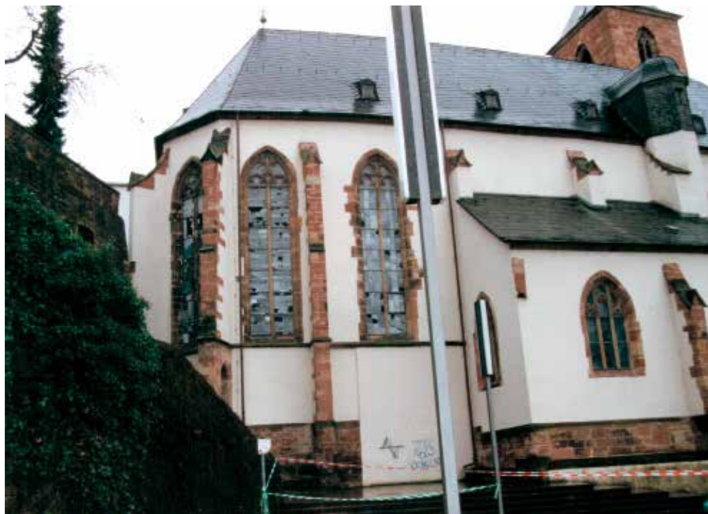
Von der Detonation zerstörte Meistermann-Fenster der Saarbrücker Schlosskirche (© Stiftung Demokratie Saarland).
